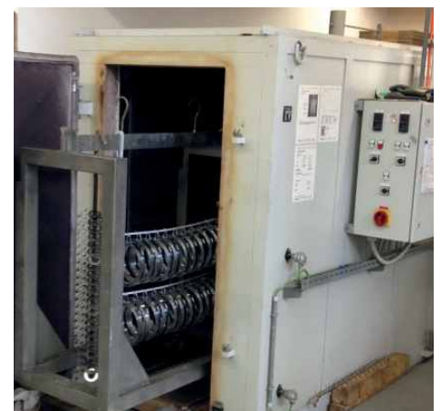
Wärmebehandlungsofen bei der Verallit AG
